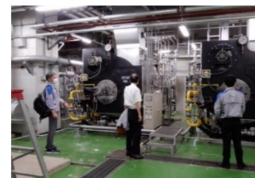
県有施設のエネルギーシフト （派遣元企業による調査）
